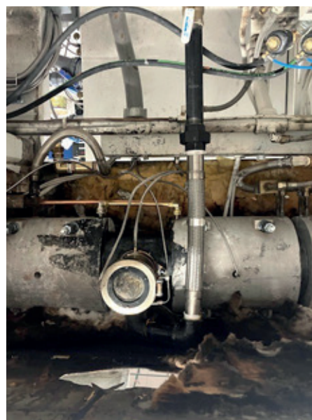
Folie Ex 6 kan nu åter vacuumavlufva extrudern.
