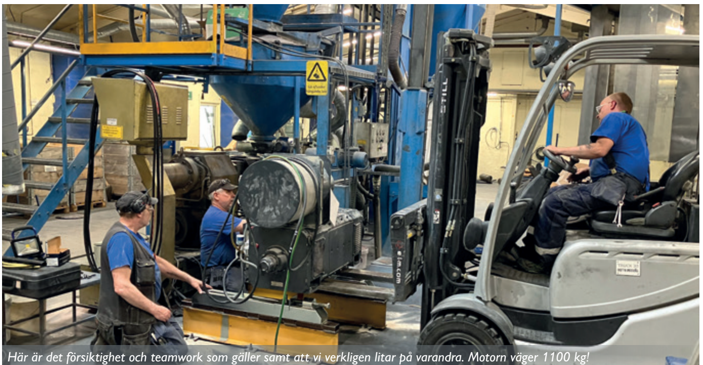
Jonas beskådar det provisoriska motorfundamentet.
